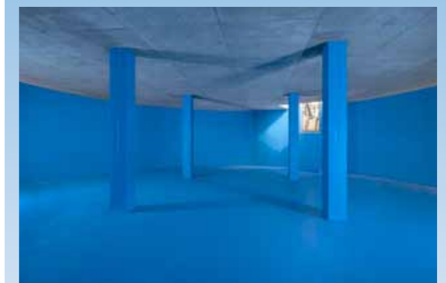
Oben: Der fertig ausgekleidete Trinkwasserbehälter Aqua-Lining 400 schafft hygienische Voraussetzungen, verringert die Unterhaltskosten und verlängert die Nutzungsdauer
