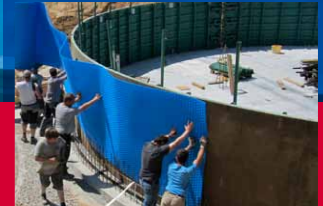
Oben: Noch vor dem Gießen des Betons werden die Polyethylen-Bahnen an die Wandverschalung angelegt
