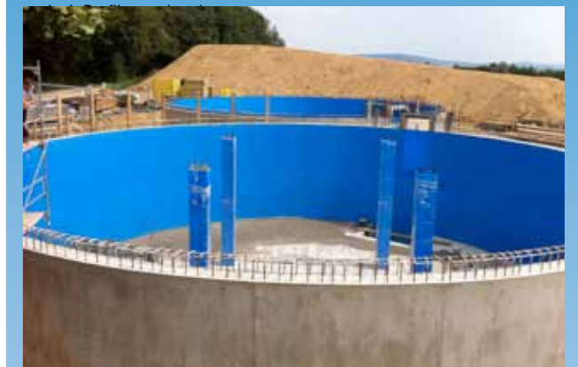
Oben: Nach Gießen und Aushärten des Betons müssen die Plattenstöße nur noch dicht verschweißt werden
